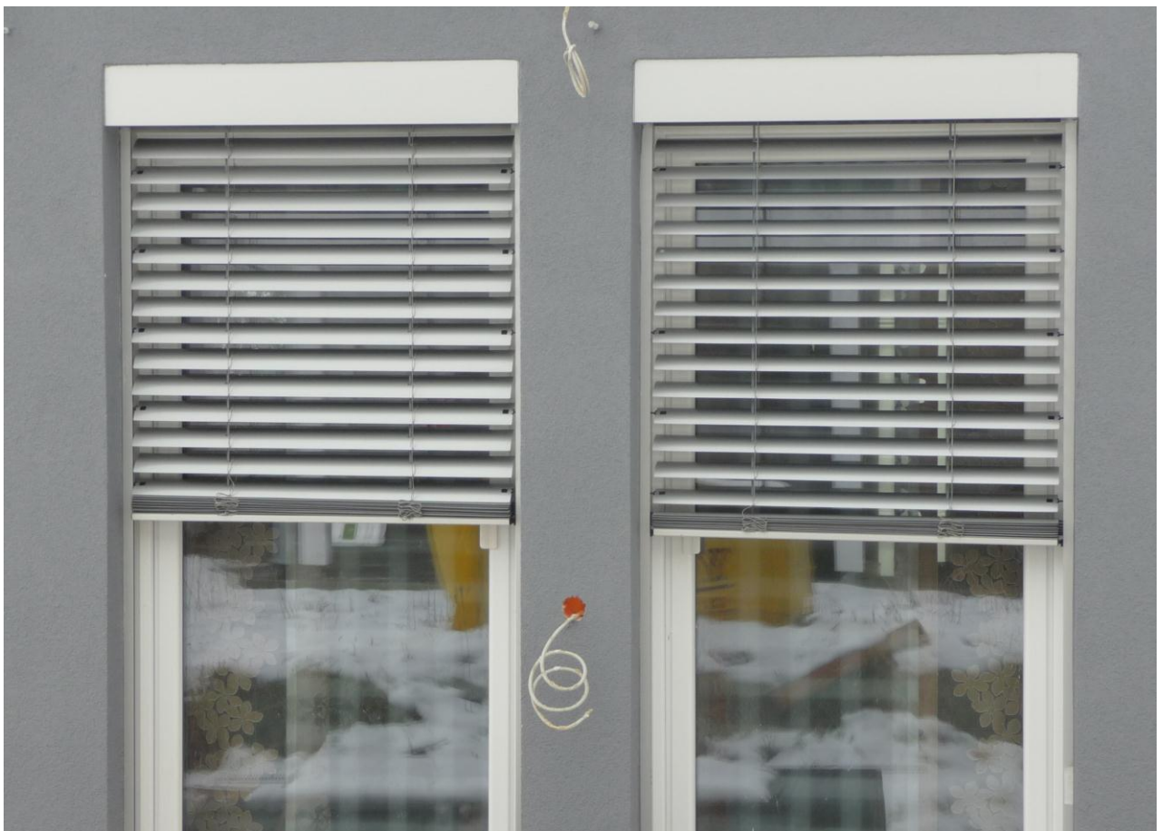
Raffstore am Neubau
